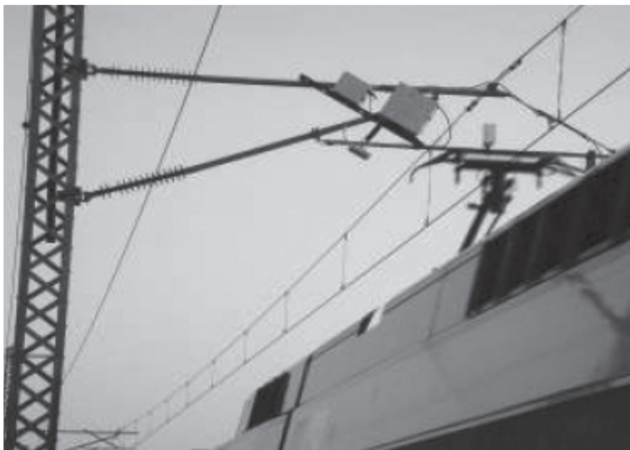
Рис. 4. Система мониторинга контактной сети на железных дорогах Кореи
