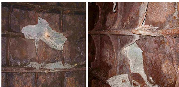
Рис. 1. Разрушение обделок стволов вследствие замерзания воды за обделкой
