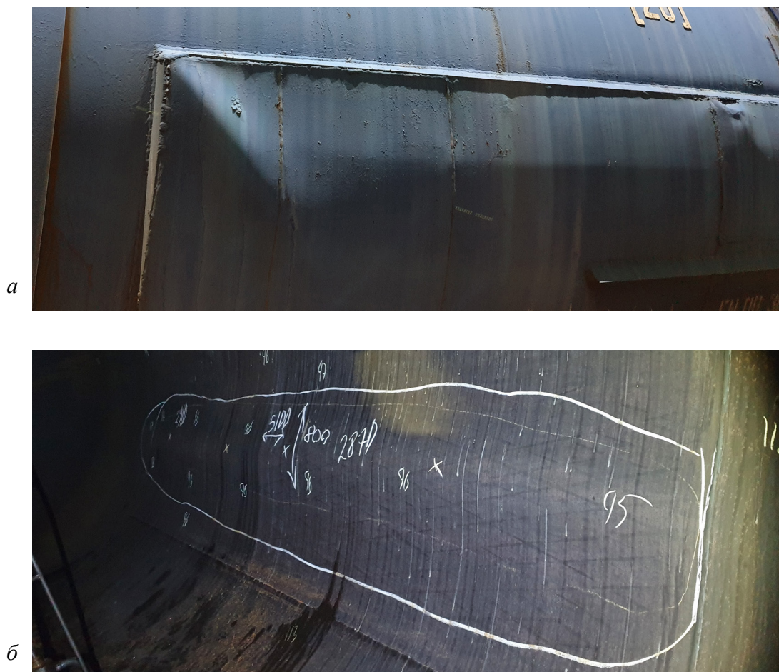
Рис. 1. Вмятина обечайки котла в зоне паровой рубашки вследствие потери устойчивости: а — вид вмятины снаружи (паровая рубашка демонтирована); б — вид вмятины изнутри котла
