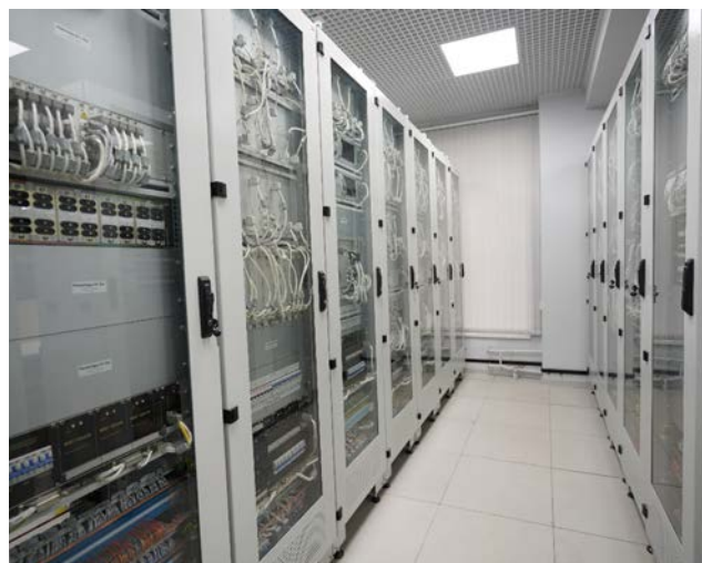
Рис. 3. Аппаратура АБТЦ-МШ, размещаемая в шкафах на станции
